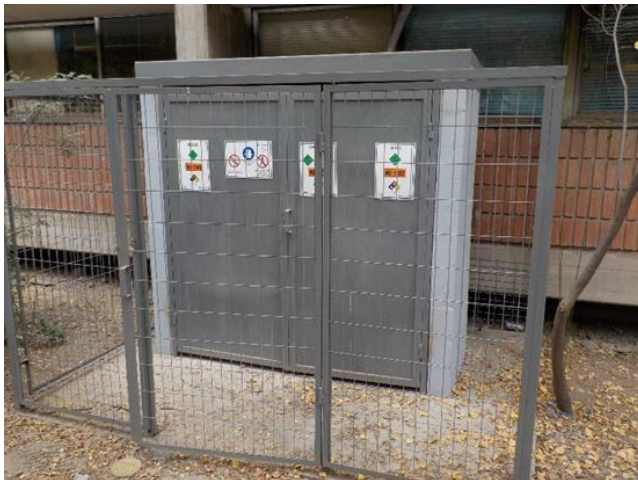
Caseta de gases implementada fuera del laboratorio
